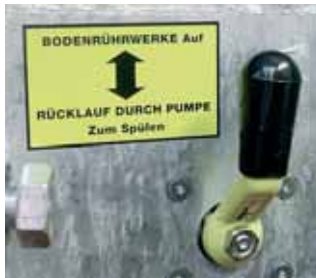
2-Weg Ventil für Bodenrührwerke und Rücklauf zum Spülen.
